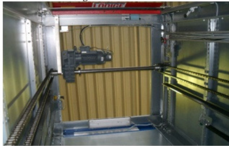
Motor vanuit schacht gezien
